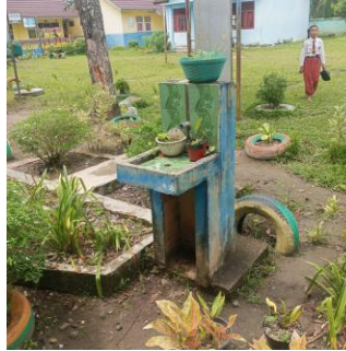
Gambar 1. Kondisi Wastafel Awal Sekolah Sumber: Dokumentasi tim pengabdian, 2025
